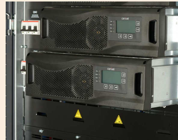
Schrank mit Modulen und internen Batterien
